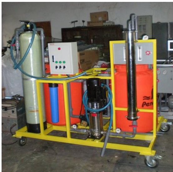
Gambar 3. Unit Pengolah Air dengan Teknologi Membran
