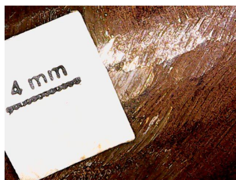
Gambar 7. Korosi menyeluruh ( Uniform corrosion )
