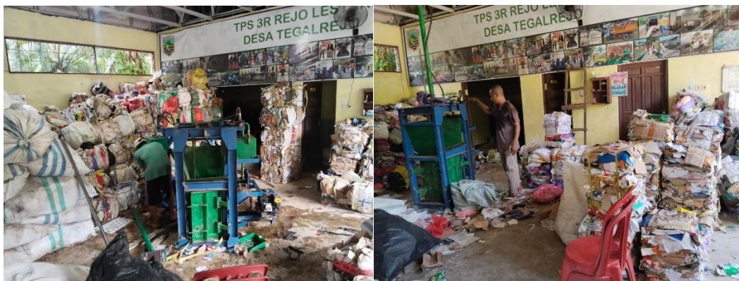
Gambar 3. A. Perawatan pada Silinder Hidrolik. B. Perawatan Mesin Press Sampah Hidrolik
